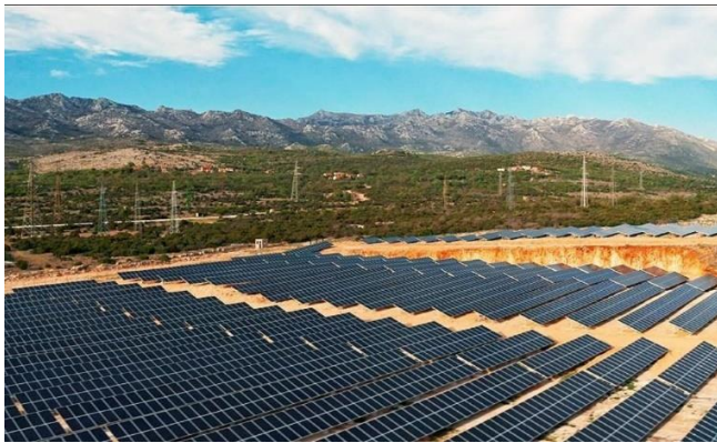
Slika 21. Sunčana elektrana Obrovac [18]
