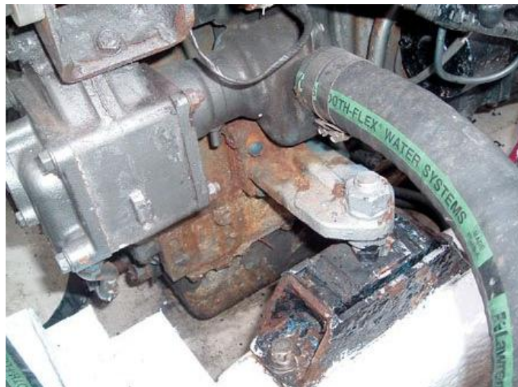
Slika 32. Korozija na dijelu strojnog uređaja [9]
