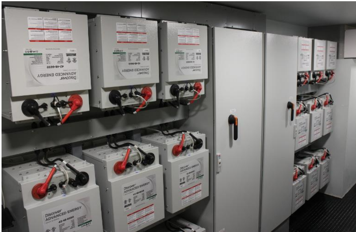
Slika 11. Baterijski sustav na brodu
