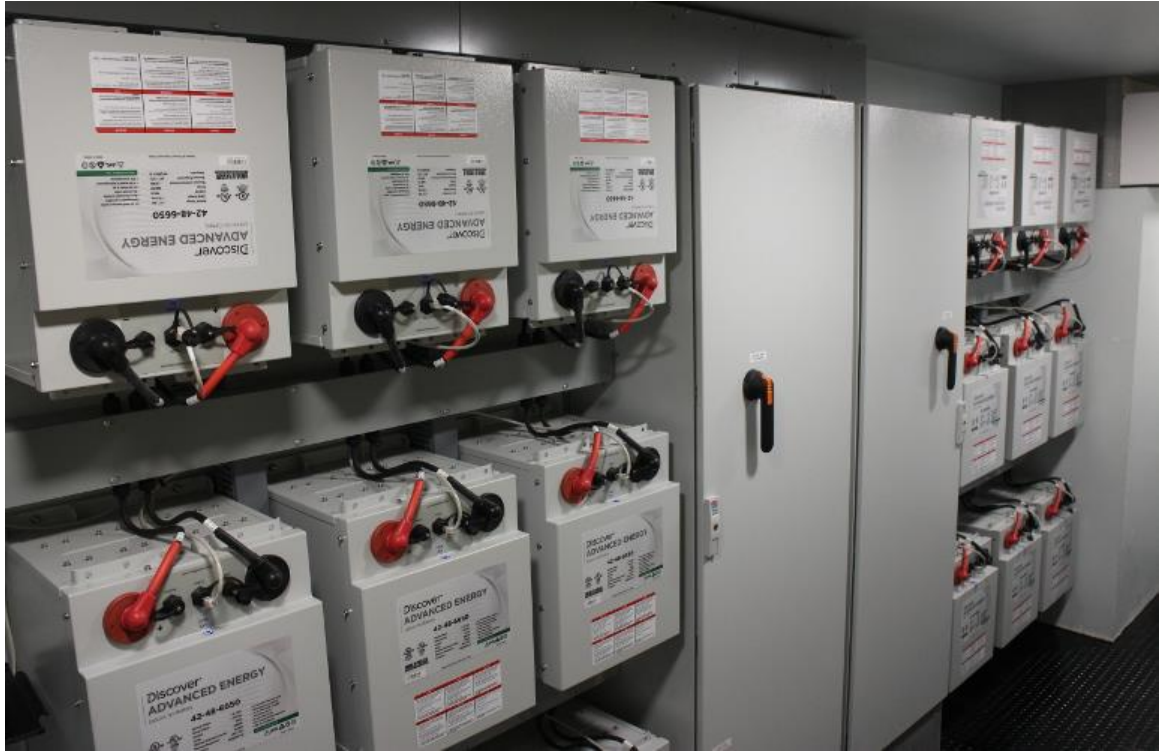
Slika 11. Baterijski sustav na brodu
