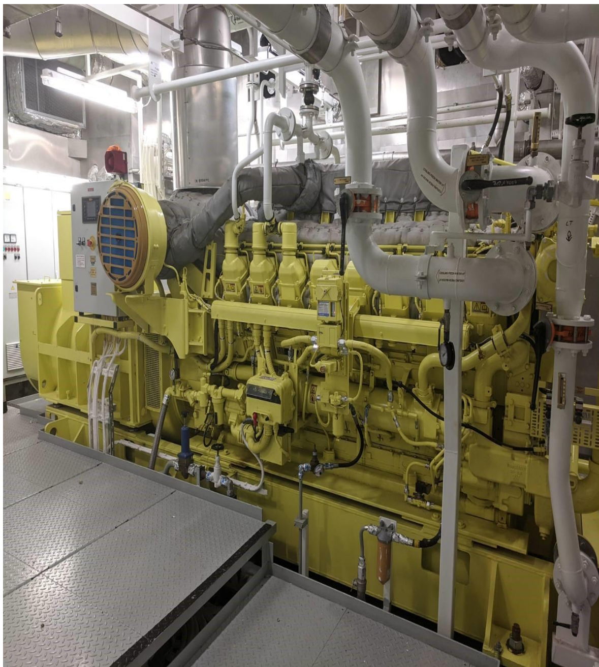
Slika 5. Dizel-generator u nužnosti.
