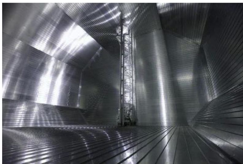
Slika 8. Unutrašnjost spremnika GT No.96 [6]
