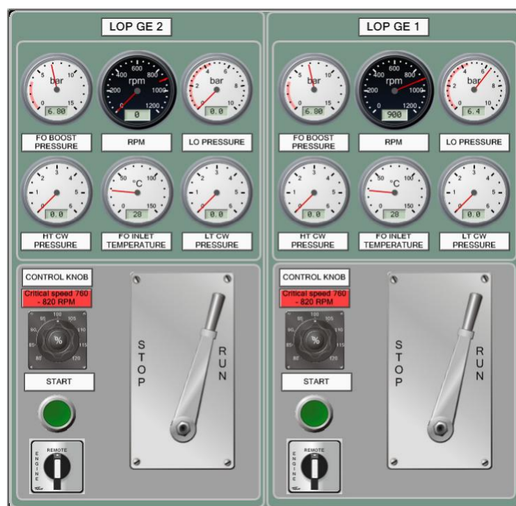
Slika 15. Operacijski panel za upravljanje dizel generatorom [3]
