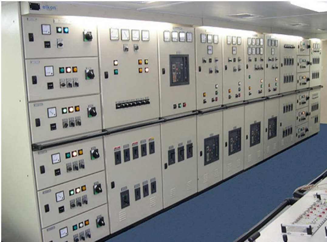
Slika 4. Glavna sklopna ploča [9]
