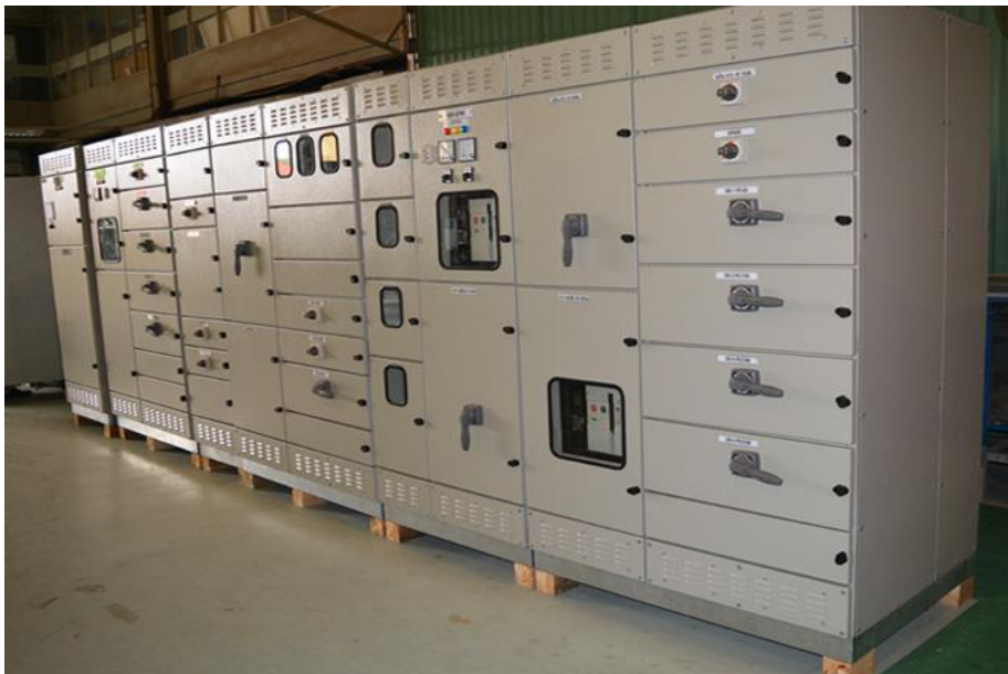
Slika 6. Glavna rasklopna ploča [17]
