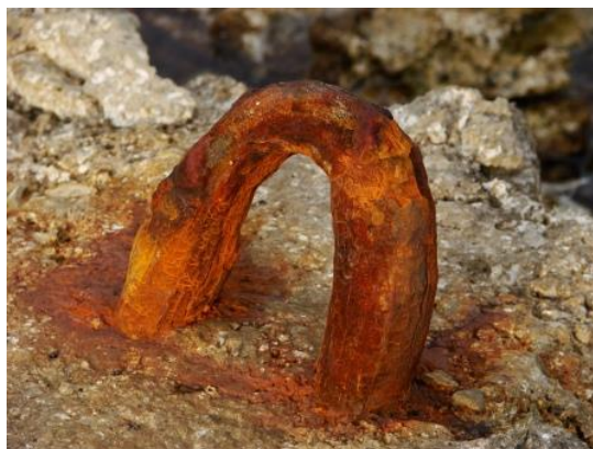
Slika 3. Progresivni gubitak materijala zbog erozije [6]
