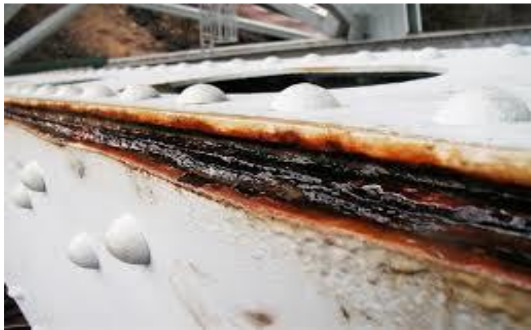
Slika 4. Korozija u procjepu [7]
